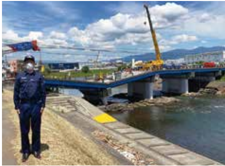
7月3日沼津市黄瀬川大橋の橋脚がV字に崩落 応急復旧仮設橋により8月31日に通行止め解除
